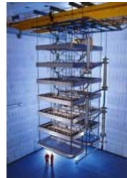
HGÜ Ventil in der Hochspannungshalle
